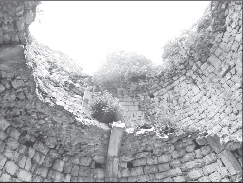
Верхняя часть башни со следами обрушения конструкций
