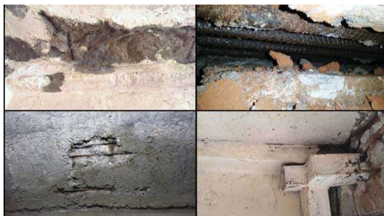
Рис. 3. Разрушение бетона без добавления модификаторов
